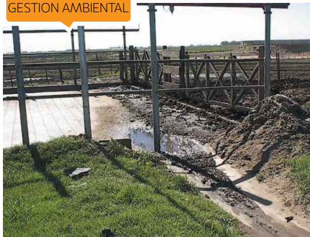
Canaleta de desague de corral de espera del tratamiento.
